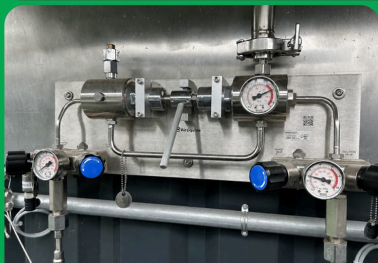
Centrales d'inversion Distribution gaz spéciaux
