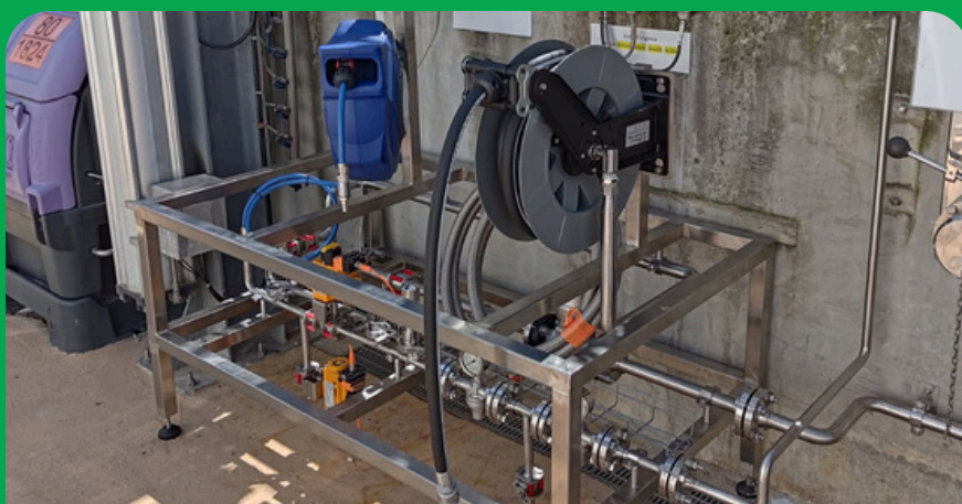
Skid de dépotage Air Comprimé & Eau Industrielle
