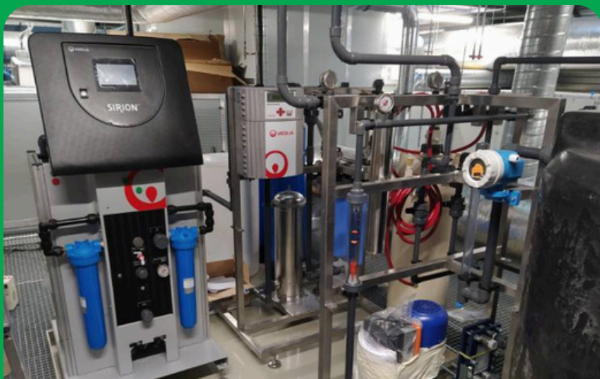
Skid Production Eau Déionisée Boucle EDI
