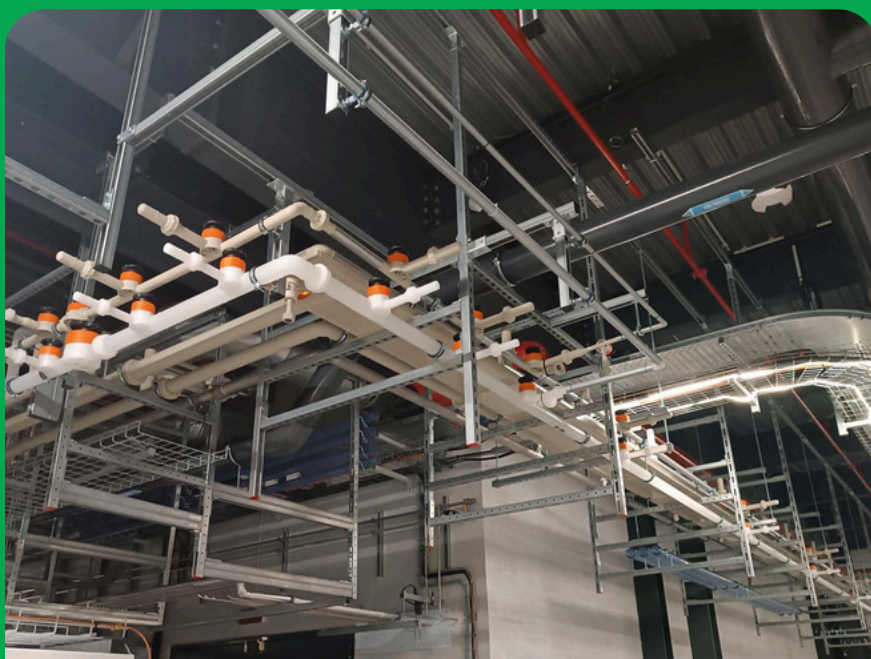
Réseaux EDI, Drains acide PPH & PVDF HP
